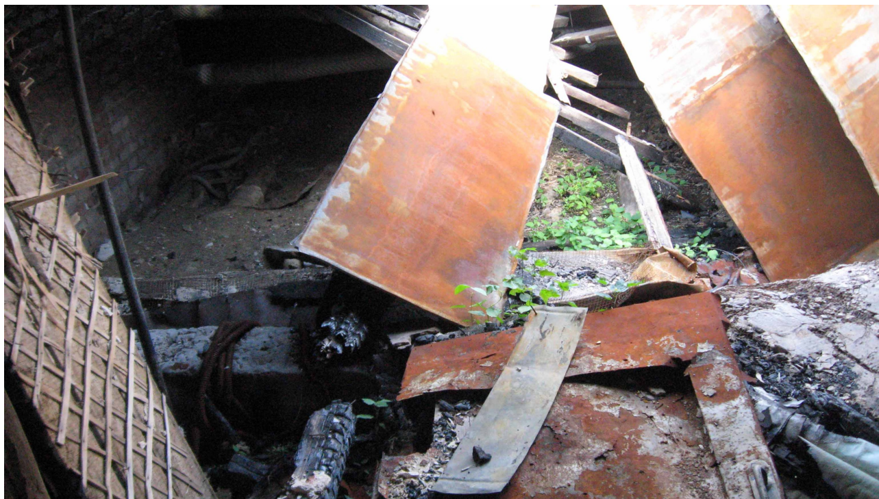
Историческое здание московской школы №201 имени Зои и Александра Космодемьянских. Обвалившаяся крыша. 2011 год.
